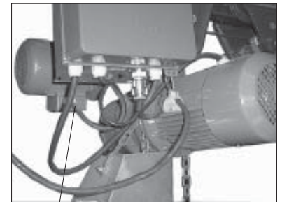
Tilkobling av kabel fra styreboks inn i koblingsboks på løpekattmotor.
